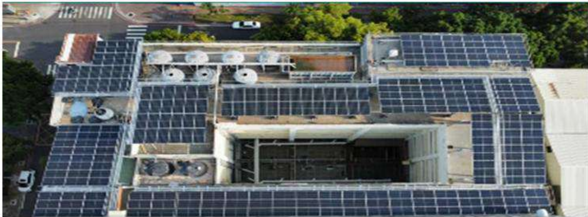
太陽能發電裝置
